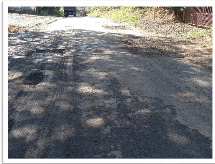
Figura 2 – Daños en el sector de la coyotera 2-09-024
