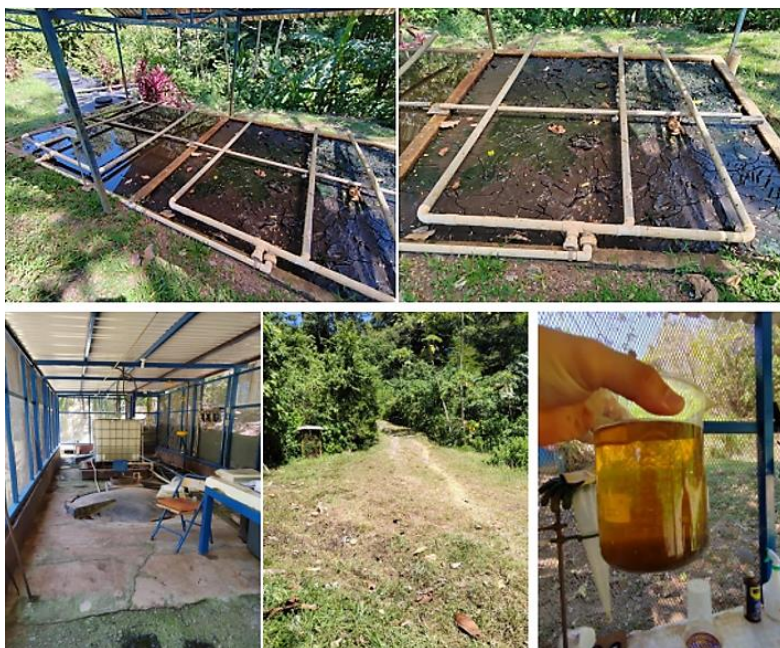
Fotografía 5: Sistema de tratamiento de aguas residuales del relleno sanitario Municipal.
