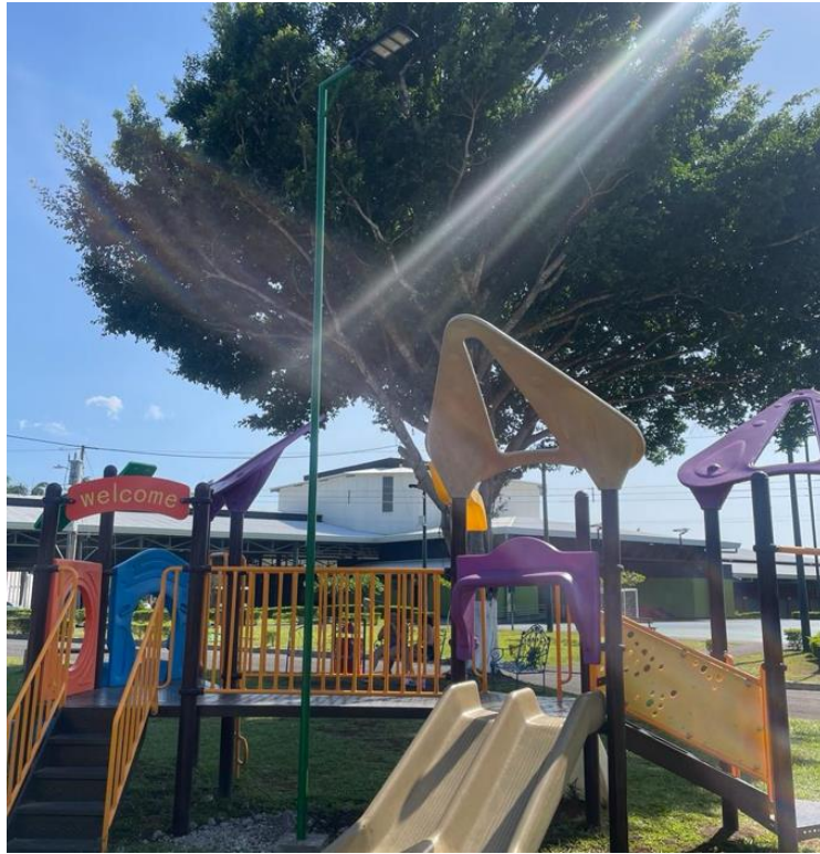
Fotografía 13. Luminarias solares instaladas.
