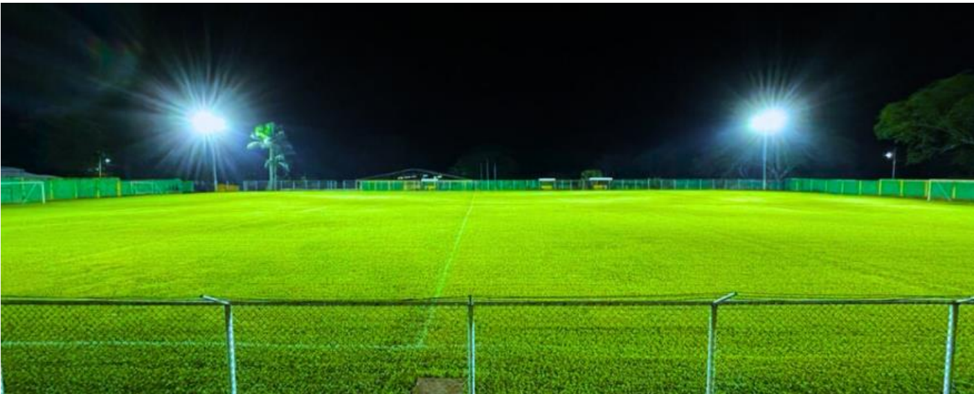
Fotografía 39. Iluminación estadio municipal.
