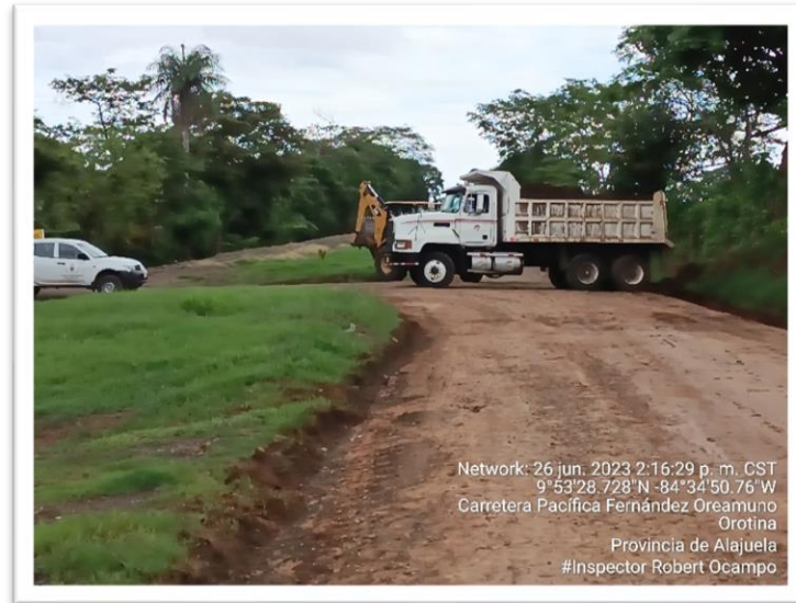
Figura 23- Estado del camino antes de la intervención sector Huacas- Pozón
